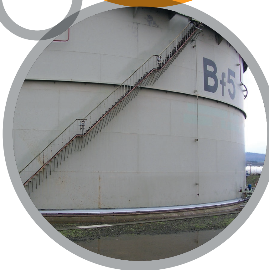
Резервуары-хранилища химических веществ
